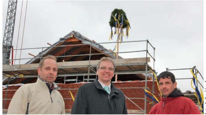
Bürgermeister Jens Böther mit den Dachdeckern vor dem Dörferegemeinschaftshaus in Garlstorf mit Richtkrone
